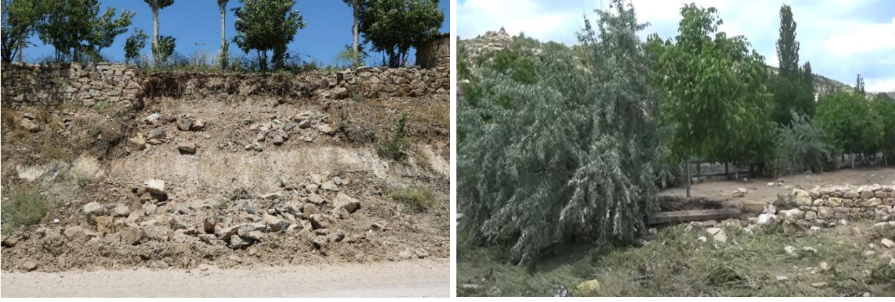
Şekil 19. Sel suları tarafından yıkılmış taş duvarlar.
