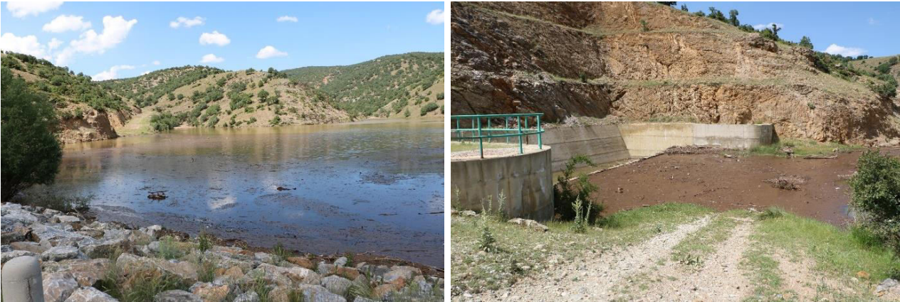
Şekil 20. Aşırı yağış sonrası Ayazini Barajı, sel sularının getirdiği balık ve çamur malzeme, ağaç parçaları ile kaplanmıştır.
