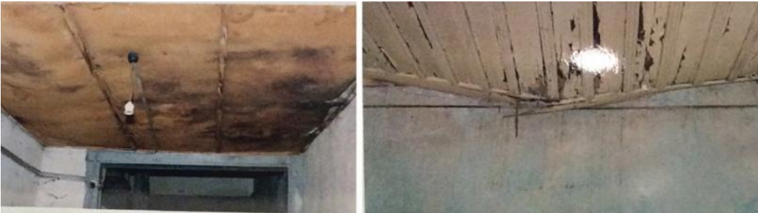
Görsel 5: Tavanda Oluşan Deformasyonlar
