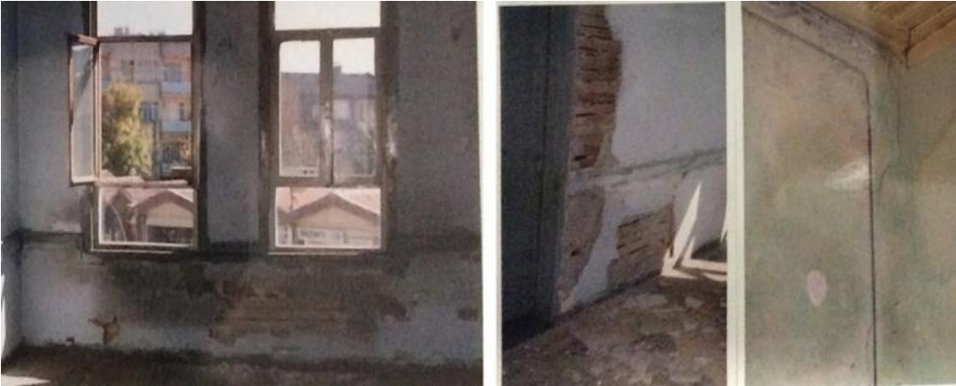
Görsel 4: İç Mekânda Sıva Dökülmeleri
