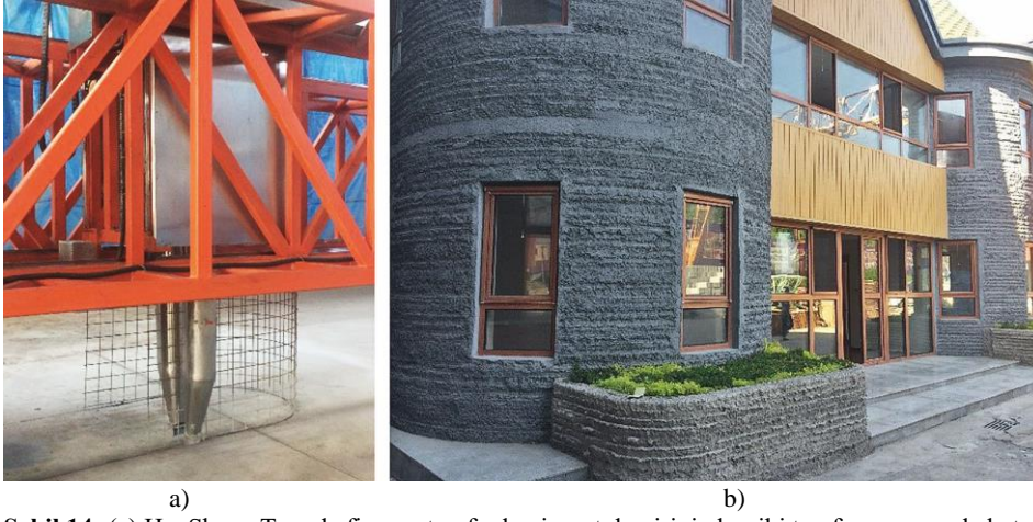
Şekil 14: (a) HuaShang Tengda firması tarafından inşaat demirinin her iki tarafına aynı anda beton yerleştiren gelişmiş nozul, (b) Çin’de HuaShang Tengda firması tarafından 3B yazıcı teknolojisini kullanarak yapılan ev
