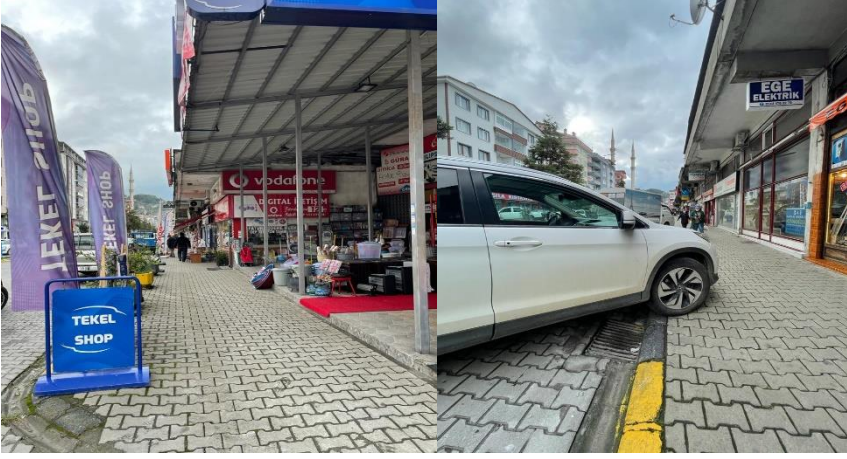
Şekil 6. İnönü Bulvarı Deforme Kaldırım ve Bordür Görüntüleri
